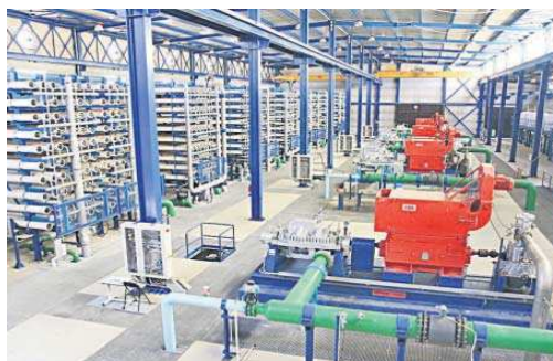
Interior de la planta desaladora 'Mar de Alborán'.
