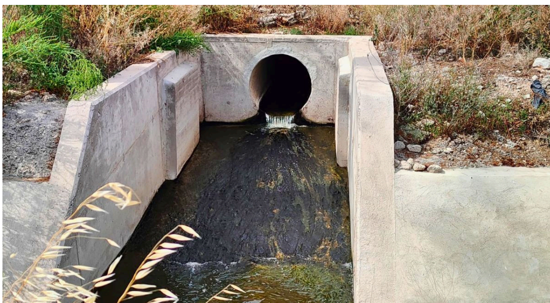
Agua depurada se vierte en el zanjón
